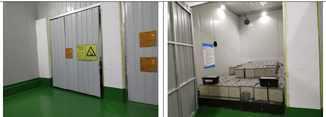
图 3-4 废铅酸蓄电池暂存间
