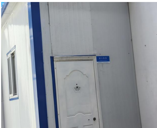
图3-9 全封闭排污泵房
