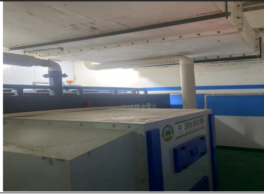
图 3-8 废气处理设备
