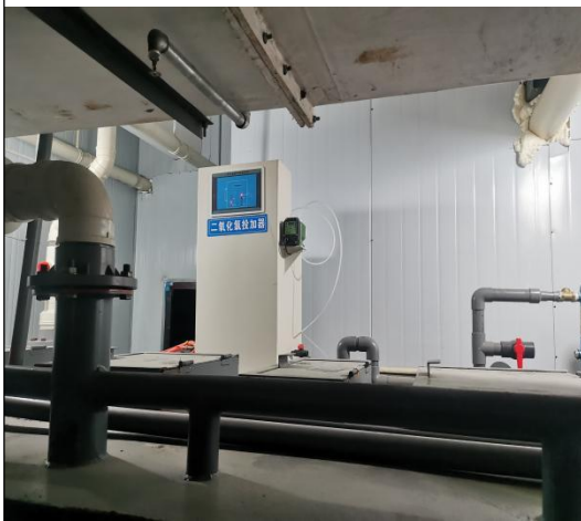
图 3-5 污水处理站二氧化氯投加器
