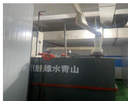
图 3-2 污水处理站整体图
