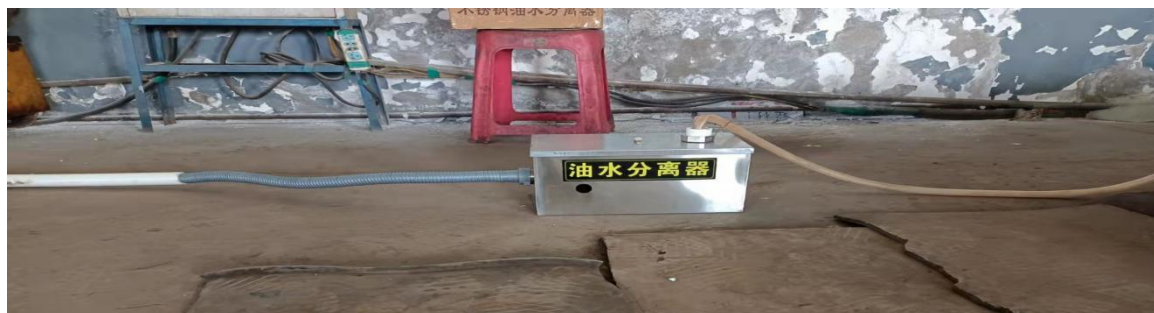
图 3-2 试压设备循环水油水分离器
