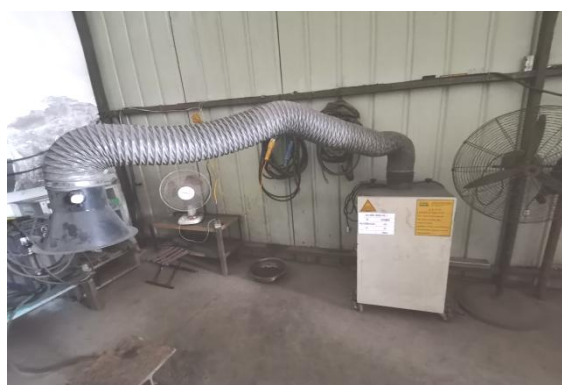
图 3-3 移动式焊接烟尘净化器
