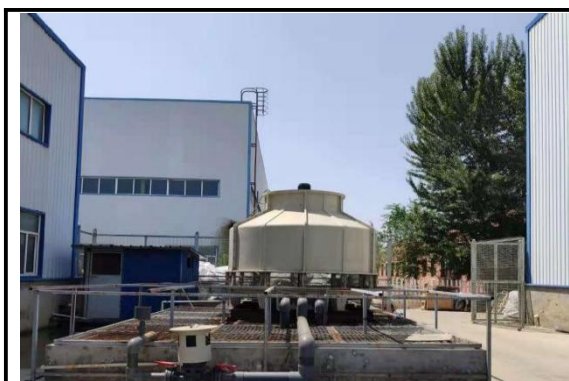
图 4-9 电解炉冷却循环水系统（自来水）
