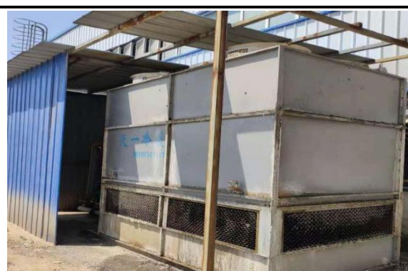
图 4-10 整流柜等冷却循环水系统（纯水）
