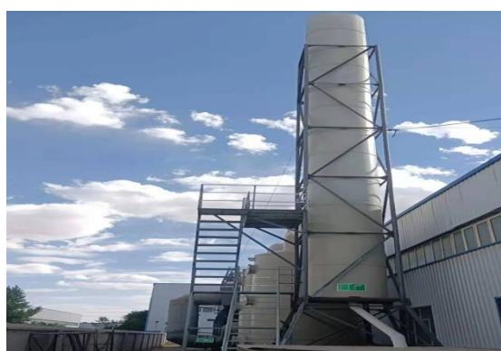
图 4-5 喷淋脱氟塔+20m 排气筒
