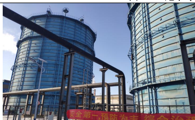
图 3-8 尾气气柜（原料气，电石项目区）
