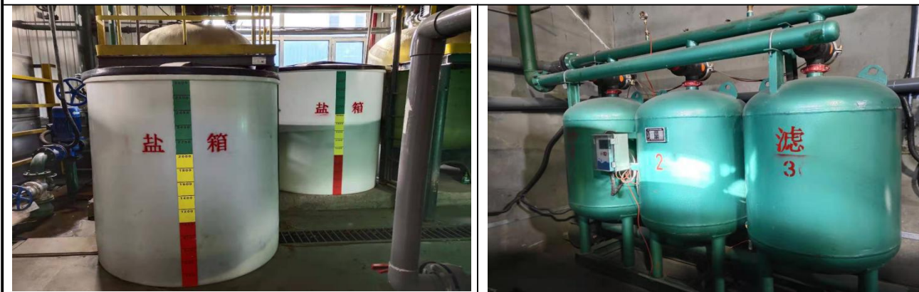
图 3-16 35T 锅炉备用软水系统
