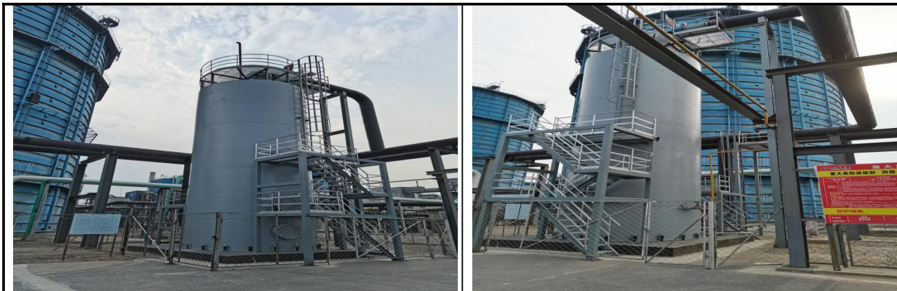
图 3-11 脱焦除尘系统
